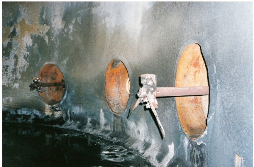
Рис.2 Мешалка с коротким валом, 30 кВт и пропеллер 1000 мм. Повреждения в части отрыва лопастей. Частые выходы из строя и ремонты.
